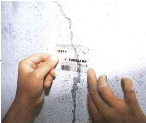
亀裂幅の測定
